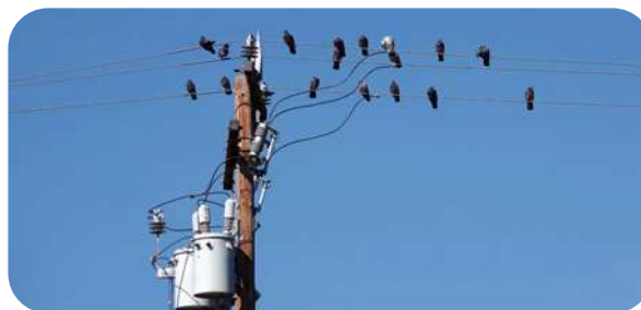
Figura 4. Palomas posadas en cables de alta tensión.
