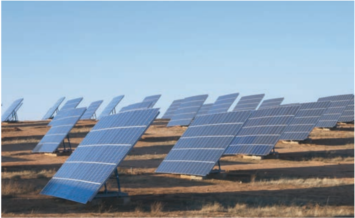
Páneles de energía solar.
