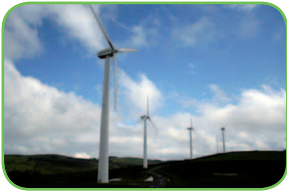
Campo energía eólica.
